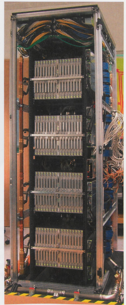
8 Ein QPACE-Rack mit 256 Prozessoren und einer Rechenleistung von 25.6 Teraflops
